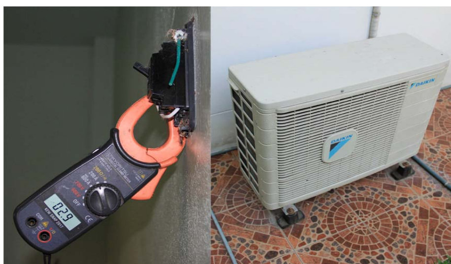
รูปที่ 4.5 ปริมาณการใช้กระแสไฟฟ้าของคอมเพรสเซอร์แอร์ ที่วัดด้วย digital clamp meter
