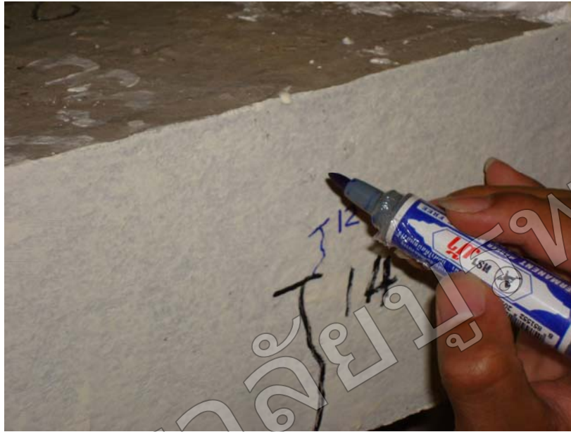
รูปที่ 3.22 แสดงการขีดบอกรางที่ทำให้คอนกรีตแตกร้าว
