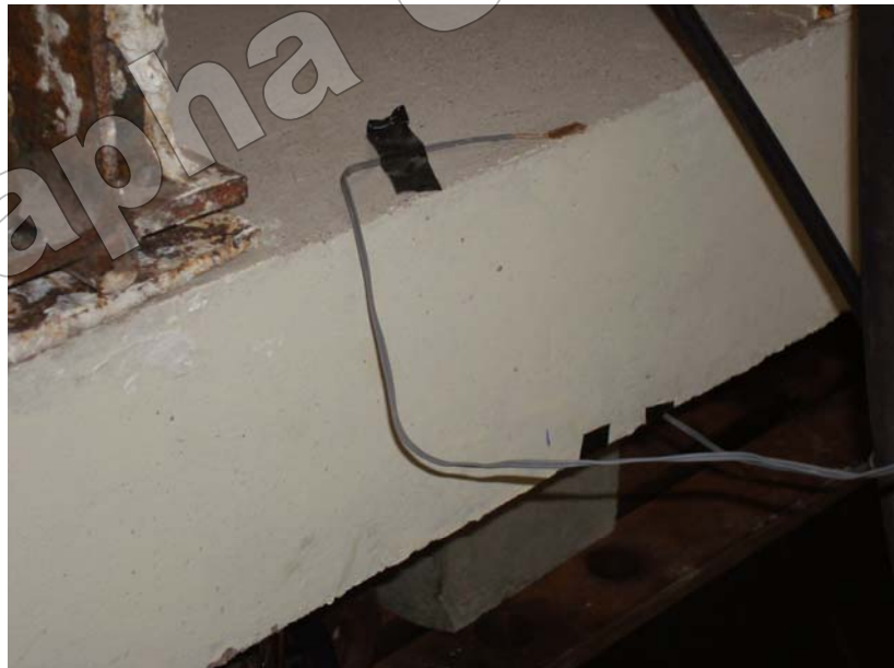
รูปที่ ข-32 แสดงการติดตั้ง Strain Gauge ที่ด้านบน และล่างของพื้น
