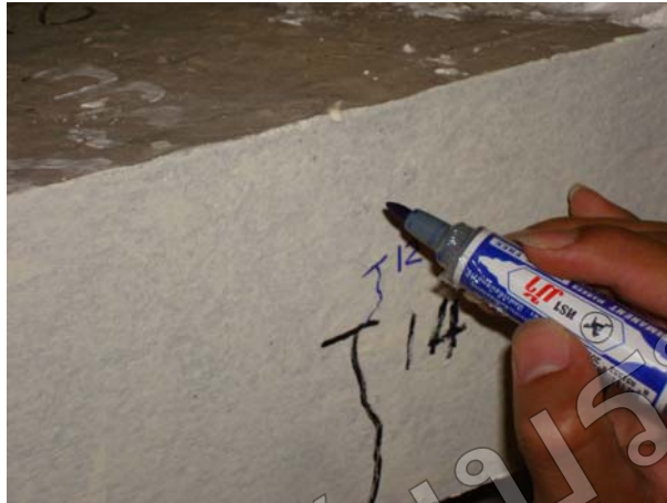
รูปที่ 4.6 แสดงการแตกของพื้นคอนกรีตเสริมไม้ไผ่จากผิวด้านล่างขึ้นสู่ด้านบน
