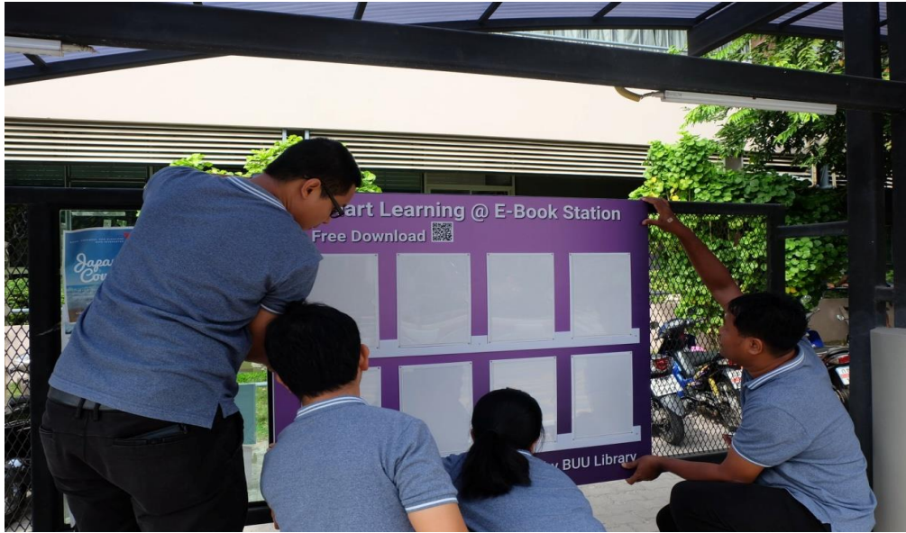
ภาพที่ 7 การติดตั้ง Smart Learning @ E-Book Station by BUU Library ที่ป้ายรอรถ สวัสดิการอาคารเรียนรวม QS (หอสมุด)
